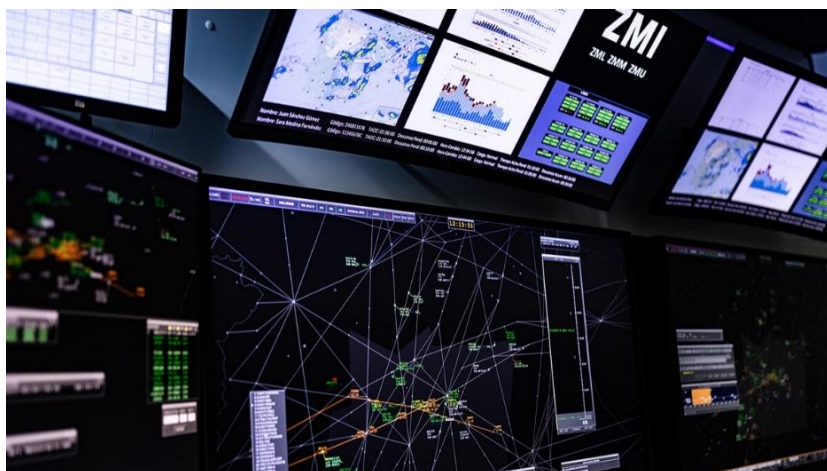
Pantallas en la Sala de Control
